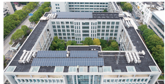
常州供电公司营配基地分布式光伏项目
