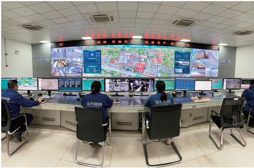
东方特钢5G智慧钢厂中控室
