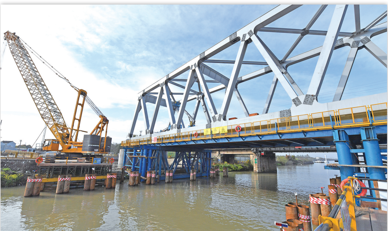
4月8日，经过近3个月的施工，单跨64米的京沪铁路改线新孟河大桥钢桁梁顺利合龙，标志着全长324米的大桥向全面建成迈出了关键一步。据悉，因新孟河航道整治，原有铁路桥下方不能满足新的通航要求，需对其进行改线建设，以满足通航升级要求。高岷 郑雨露 杨建伟图文报道
