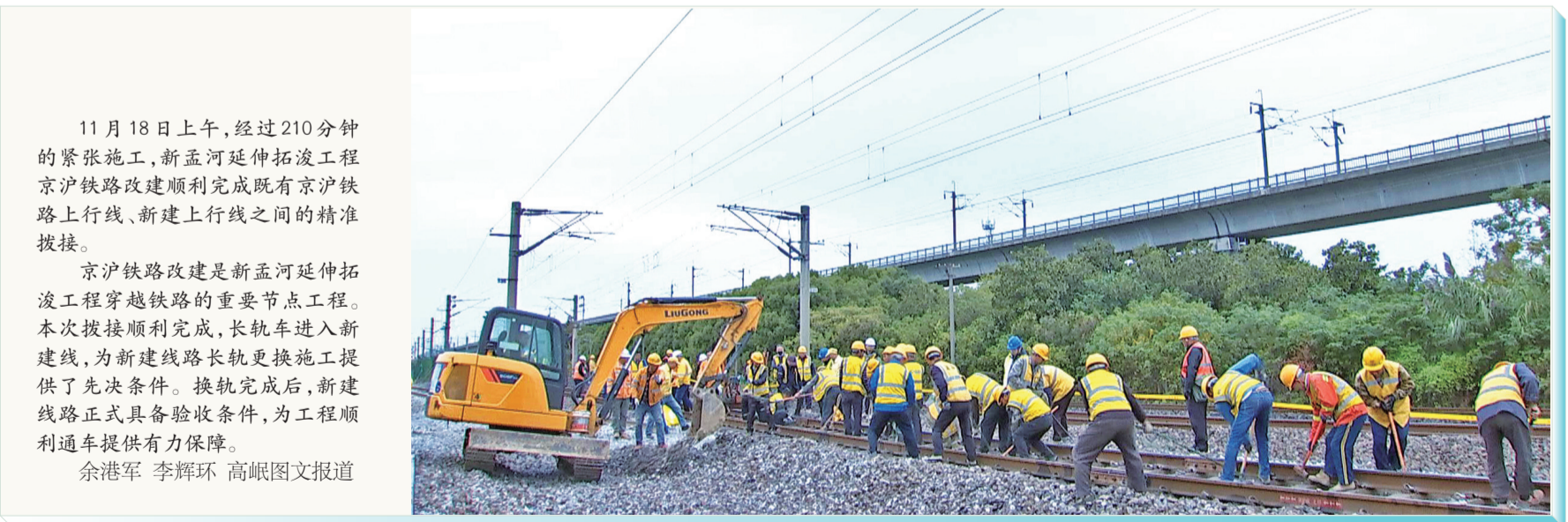
11月18日上午，经过210分钟的紧张施工，新孟河延伸拓浚工程京沪铁路改建顺利完成既有京沪铁路上行线、新建上行线之间的精准拨接。
