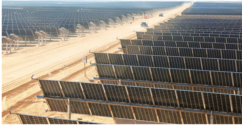
这是11月9日拍摄的位于埃及南部阿斯旺省的康翁波光伏电站。
