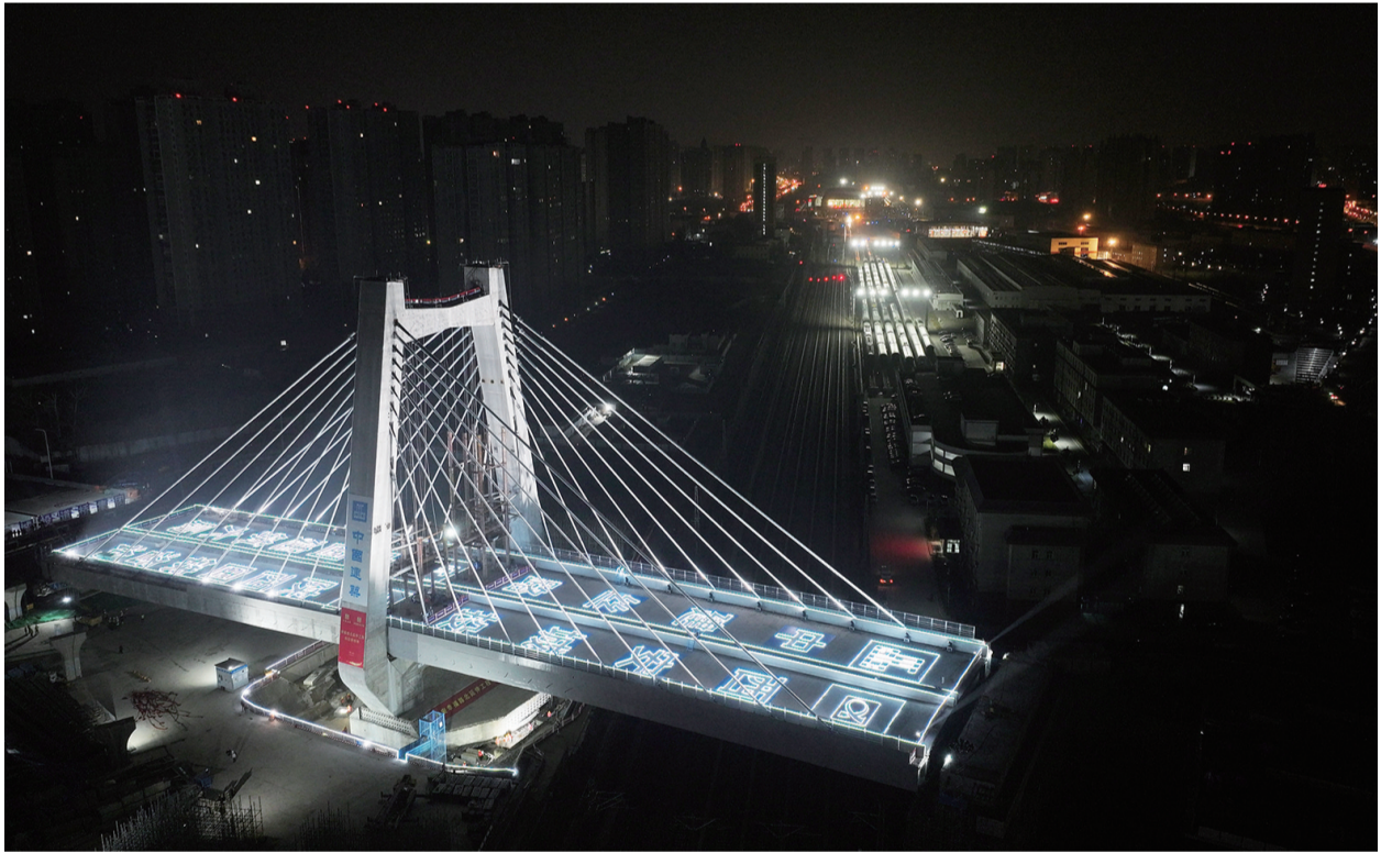
3月8日,由中建六局、中建丝路承建的西安幸福路北延伸工程独塔斜拉桥,经过120分钟逆时针旋转69.45度后,跨越陇海铁路,实现成功转体。该座斜拉桥总重量约4.8万吨,总长约161米,是西安市优化城市路网的重点工程。这是正在进行转体施工的西安幸福路北延伸工程独塔斜拉桥(3月8日摄,无人机照片)。
