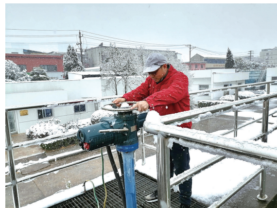
清潭净水泵站工作人员检查补水设施设备
